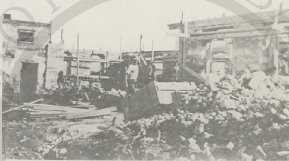
1956: Εργασίες ανοικοδόμησης της ανατολικής πτέρυγας του Γηροκομείου Χανίων. (Αρχειο Δημοτικού Γηροκομείου Χανίων).
